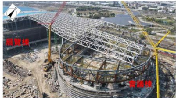
會議棟施工順序：先施作筏基，吊裝鋼梁柱，地上層結構施築，TREEGATE及會議棟屋頂桁架吊裝，施工方向由中間向兩側。
