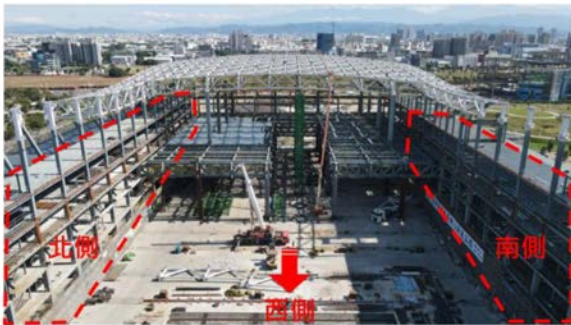
展覽棟施工順序：南北側筏基，吊裝兩側鋼構梁柱，再施作中間挑空區筏基，吊裝4F鋼桁架及屋頂桁架，施工方向採由西向東。
