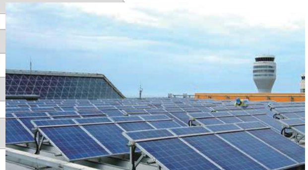
第二航廈擴建區屋頂太陽光電發電設備 （圖片來源：機場公司官網）
