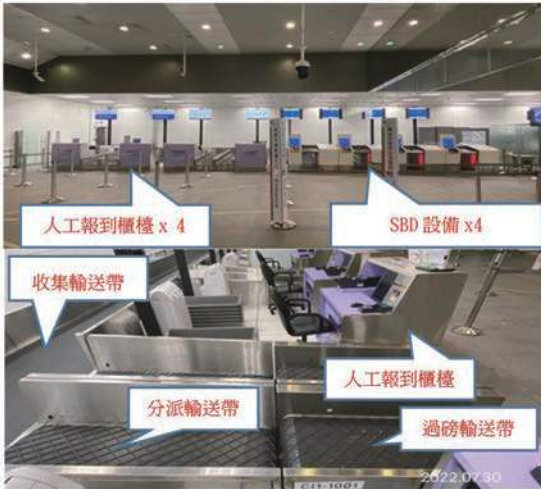
圖 3 A3 車站穿堂層行李處理區實況（人工報到櫃檯、SBD 設備、過磅輸送帶、分派輸送帶及收集輸送帶）
