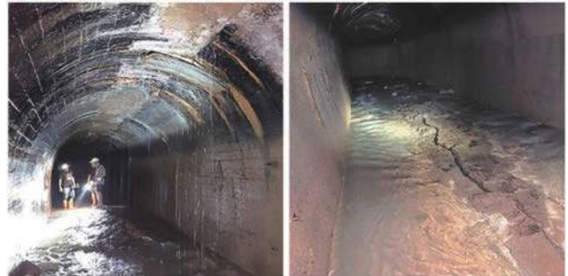
圖 4 桃園大圳導水路第三號隧道 2K + 900 位置頂拱與仰拱底板狀況（本團隊拍攝）
